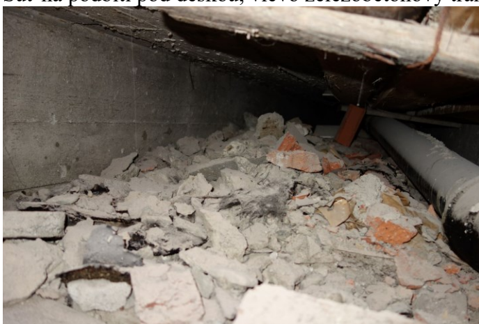
Suť na podbití pod deskou, vlevo železobetonový trám (foceno otvorem sondy)
